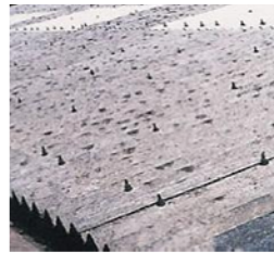
Asbestzementdach, unverwittert, identifizierbar
