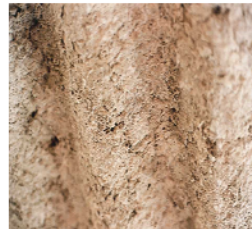
Asbestzementdach, verwittert, leicht zu identifizieren
