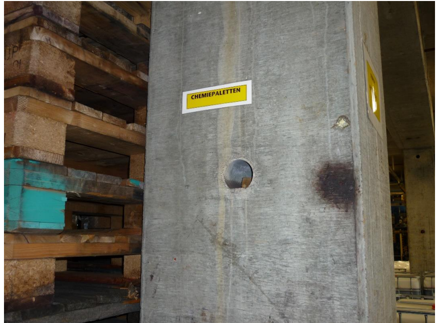
Bild 5: asbesthaltige Baumaterialien: Rohrhülsen
