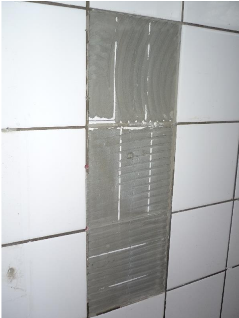
Bild 4: asbesthaltige Baumaterialien: Fliesenkleber
